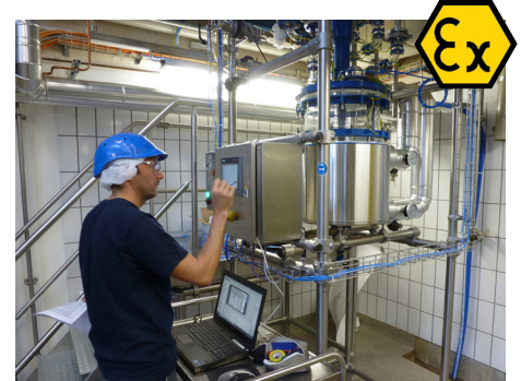
100 liter chemReactor with ATEX PLC control system 100 Liter chemReaktor mit ATEX SPS Steuerung
