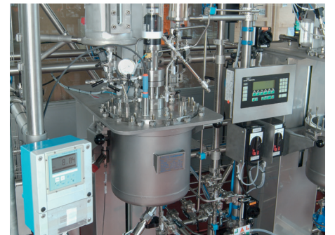
Control of suspension-polymerisation Steuerung Suspensions-Polymerisation
